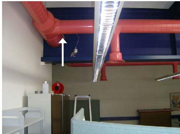
Abb. 14: Luftkeimmessung innerhalb des Zuluftkanals
