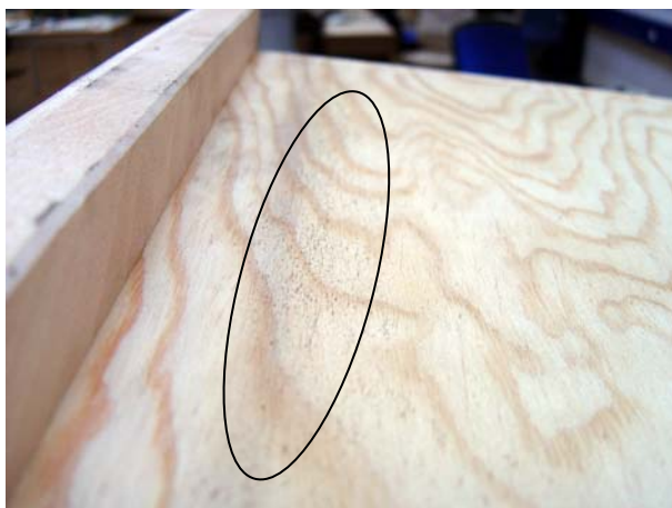
Abb. 10: Holzoberfläche zuluftseitig mit Schimmelwachstumsspuren
